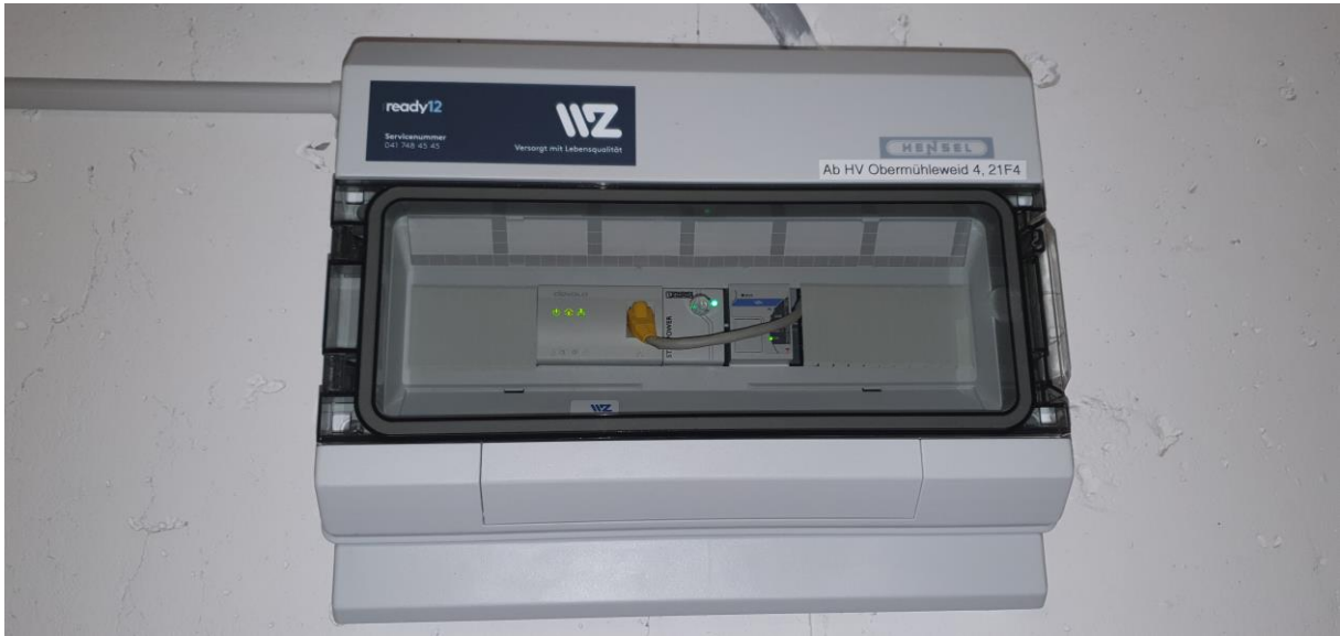
Kommunikationsbox: 1 x für die ganze Einstellhalle
