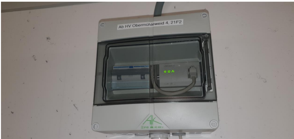
Unterverteilung: oberhalb jeder Ladestation
